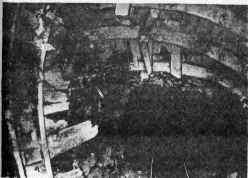
Рис. 15. Деформации металлической податливой крепи в капитальном уклоне гор. 1200 м шахты им. А.А. Скочинского ПО "Донецкуголь"
