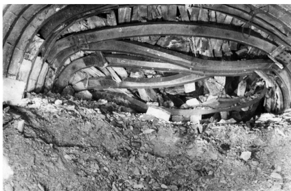
Рис.2. Состояние крепи 2-го южного квершлага после выброса породы 8.03.62г. шахты «Щегловская - Глубокая».
